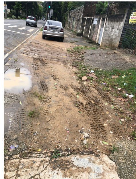
09/04/2023: calçada com estado ruim para passagem de cadeirante
