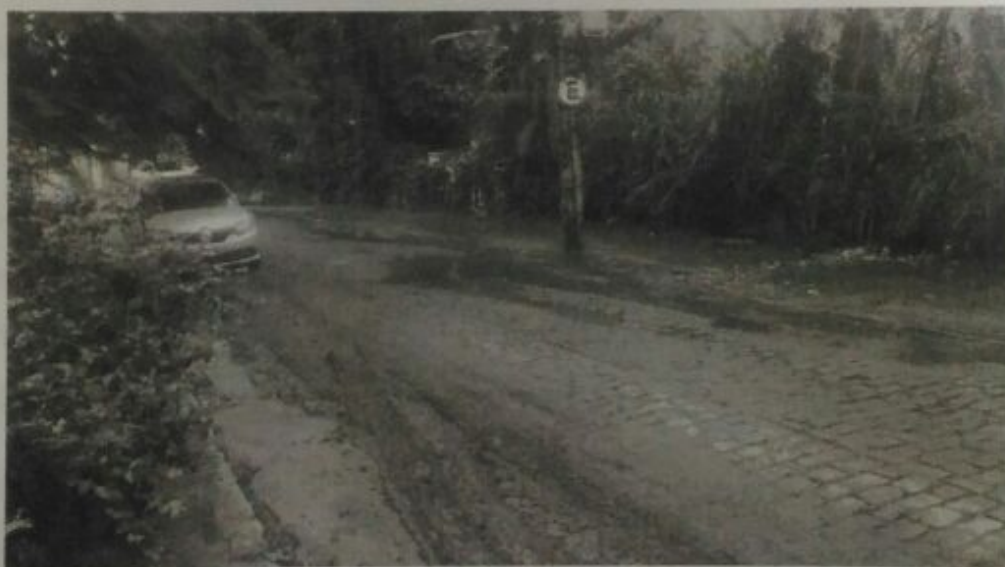
Foto 2: Trecho da ocorrência do alagamento.
